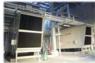
CGS (コージェネレーションシステム)
