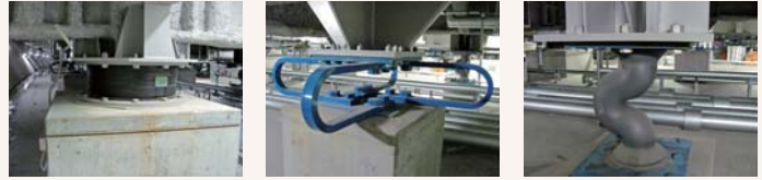
地下ピットの免震装置（左から、積層ゴム、鋼製U型ダンパー、鉛ダンパー）
