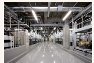
熱源機械棟：冷凍機
