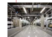
熱源機械棟: 冷凍機
