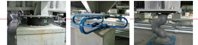
地下ピットの免震装置 (左から、積層ゴム、鋼製U型ダンパー、鉛ダンパー)
