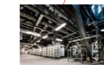
計算機棟空調機械室
